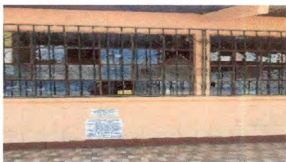
foto 5. Sustrucción de vidrios (módulo de aulas)
